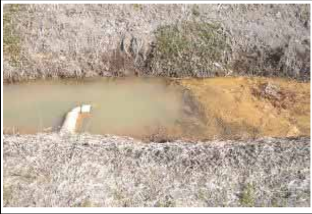
土石が貯まって流れを止めてしまった。
